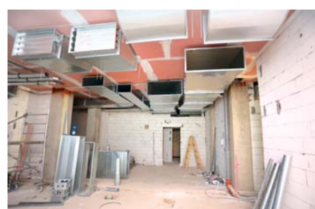
Stropy budoucí kuchyně jsou „vytuňovány“ novou vzduchotechnikou.
