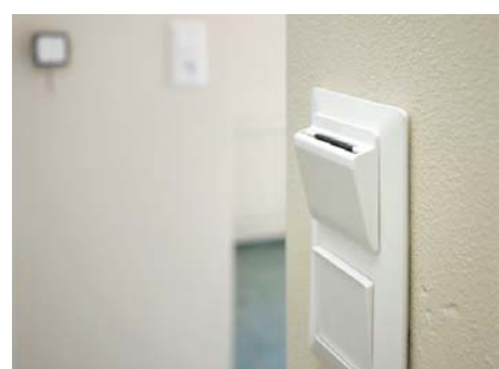
V rámci nových elektrických rozvodů byla na pokojích instalována čidla na klientské karty.
