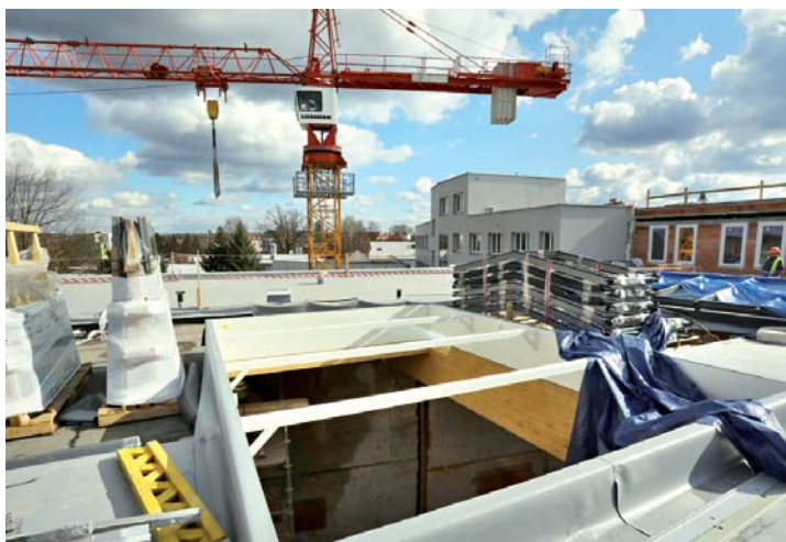
Od naší minulé návštěvy přibyla například střecha se třemi obrovskými světlíky nad budoucí jídelnou.
